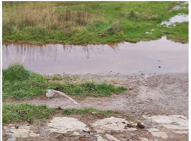
Par endroits, la voie verte, en bas de digue, est impraticable!
